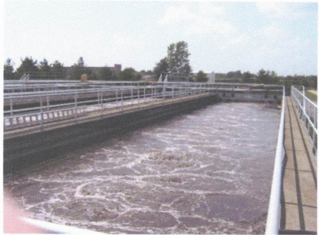
บ่อบำบัดน้ำเสีย
